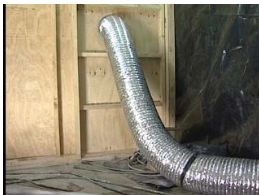
شکل ۶-۱۶- مکش گرد و خاک با استفاده از اجرای سیستم تهویه
