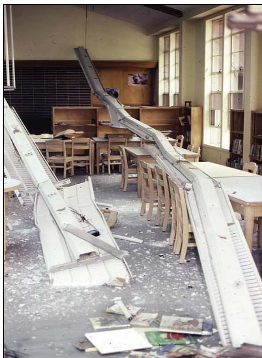
شکل ۱۰-۲- آسیب به سیستم روشنایی در هنگام زلزله
