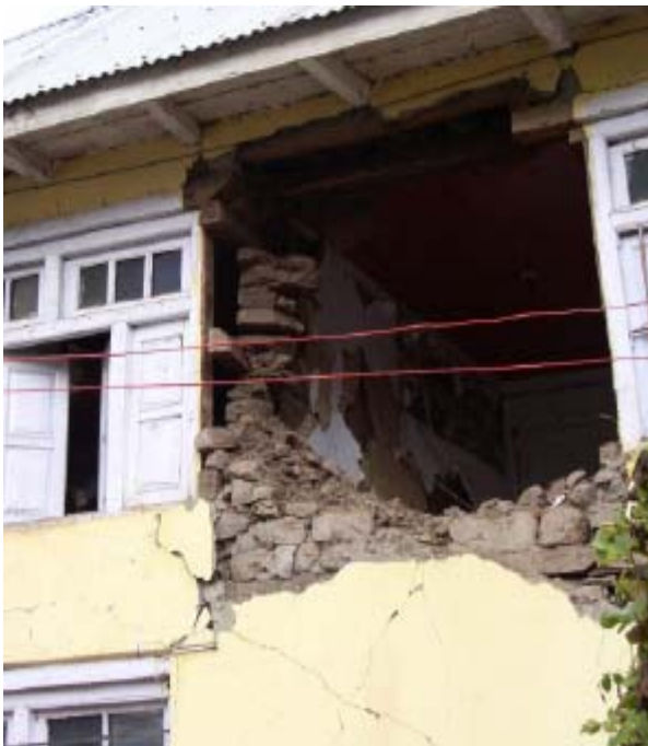
خرابی به علت ضعف در محل اتصال دیوار به سقف ضعیف
