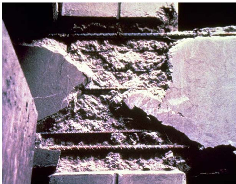
شکل ۲-۶-۸ کمانش میلگردهای طولی تیر در ناحیه اتصال
