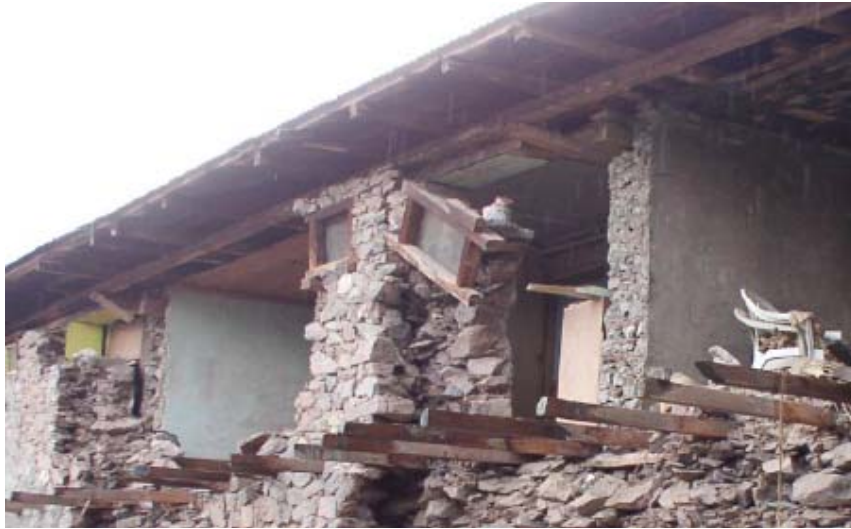
خرابی به علت ضعف در مقاومت خمشی دیوارهای بنایی
