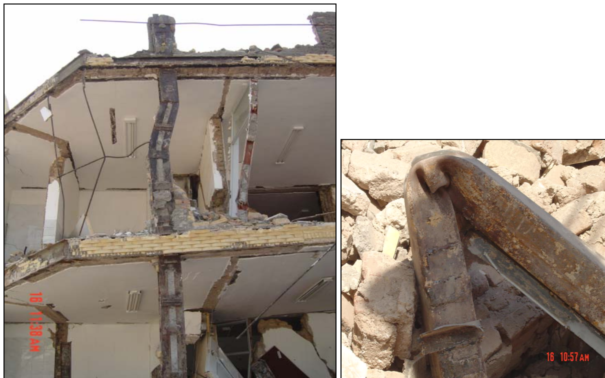
شکل ۲-۵-۱۹- نمونه‌ای از خرابی ستون‌های فولادی
