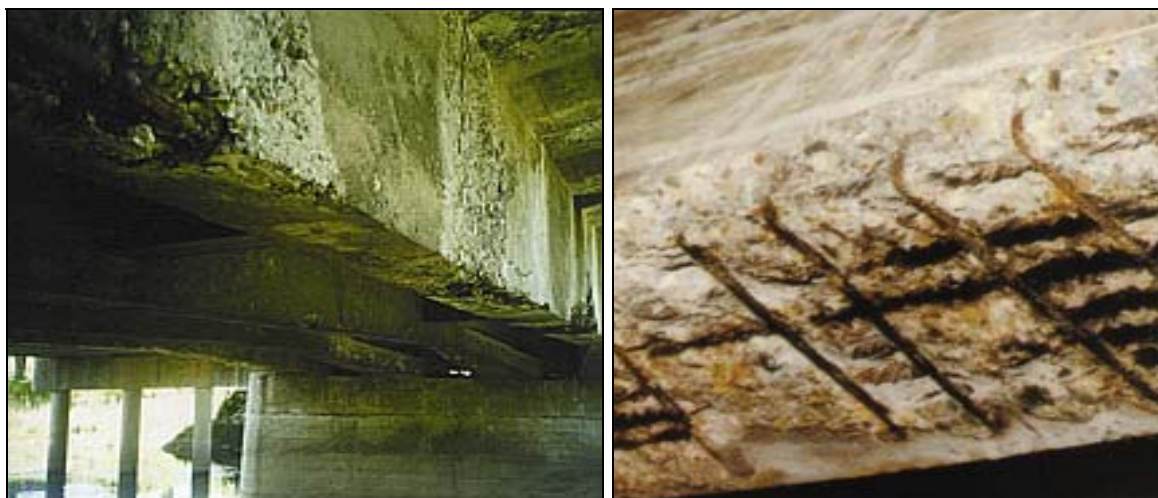
شکل ۲-۴-۱- نمونه‌هایی از آسیب‌دیدگی تیرهای بتنی
