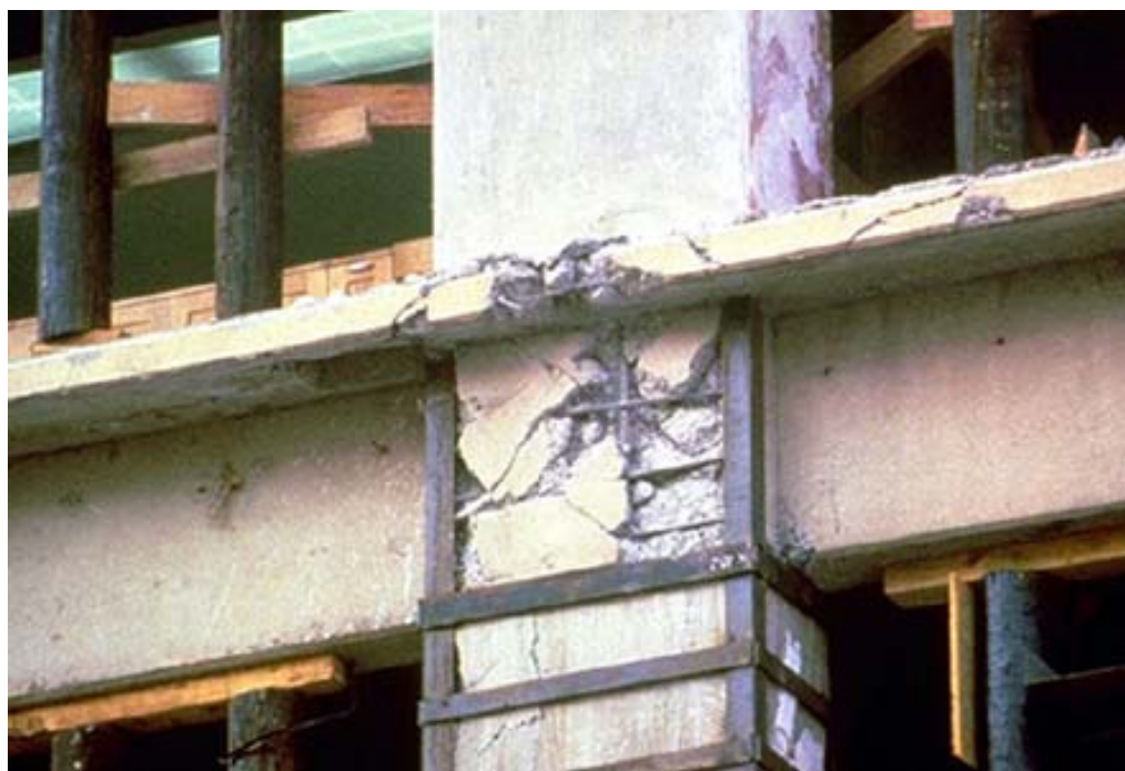
شکل ۲-۶-۷ کمانش میلگردهای طولی ستون در ناحیه اتصال
