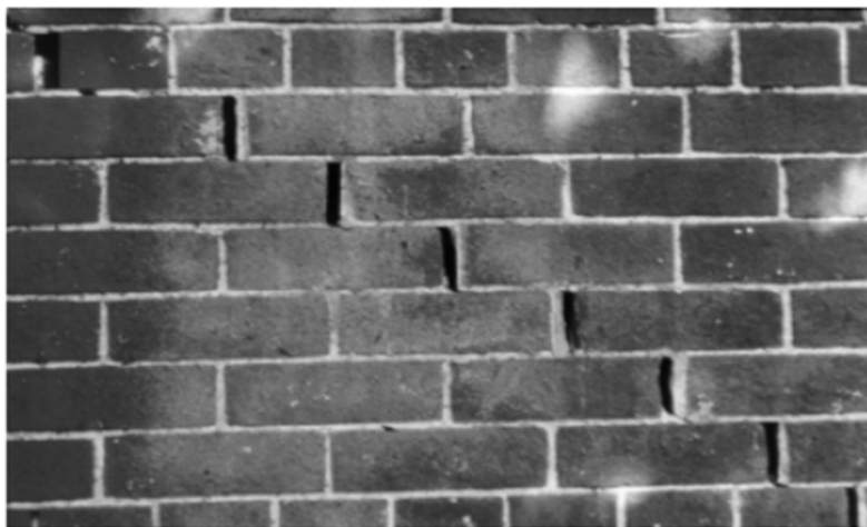
شکل ۸-۵ - لغزش درز ملات پس از ترک خوردگی قطری
