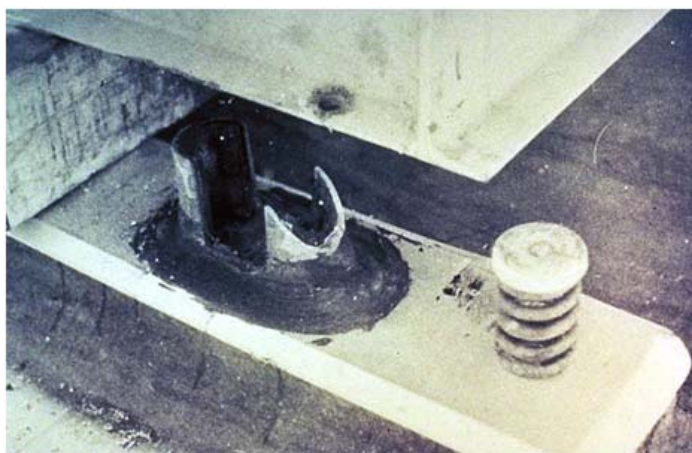
شکل ۹-۱۰ - آسیب وارده به جداگر فنری در زلزله
